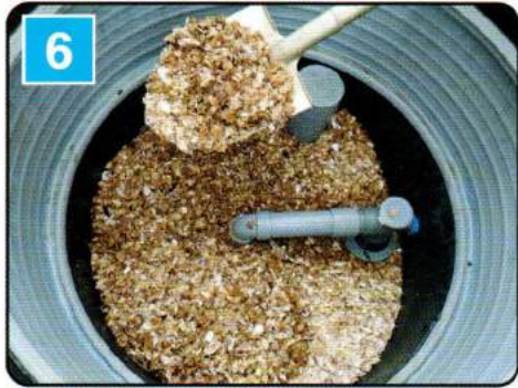
⑥ バイオクリーン剤の点検・補充 スコップ等を使用して、槽内のバイオクリーン剤の天地換えを行います。 またバイオクリーン剤の量が減少している場合には補充して下さい。
