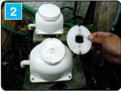
② ブロウの点検 ブロウの稼動状況を確認します。 ダイヤフラム磨耗の確認、フィルターが汚れている場合は清掃または交換します。
